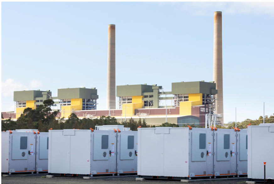
Wärtsilä establece un nuevo referente mundial con la cuarta fase del sistema de almacenamiento de energía en baterías Eraring de Origin
