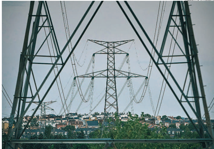
Redes de alta tensión en Madrid
