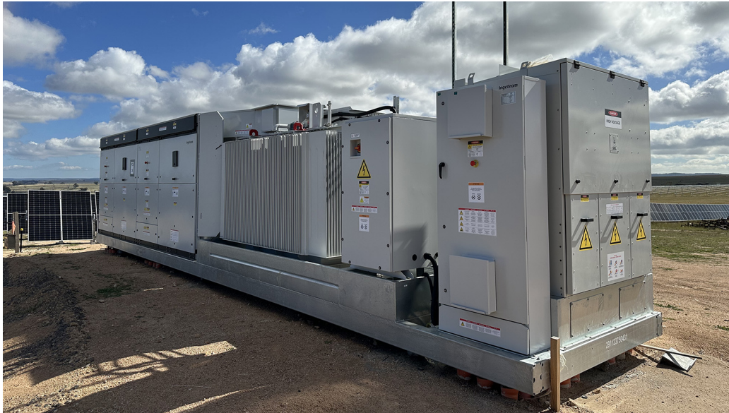
Ingeteam suministrará 100 MW fotovoltaicos y 100 MW / 2h de BESS para un proyecto híbrido de European Energy Australia.
