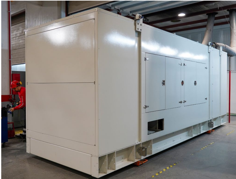
Genesal Energy refuerza con tres grupos electrógenos la sostenibilidad de la mayor depuradora de la Comunidad Valenciana.
