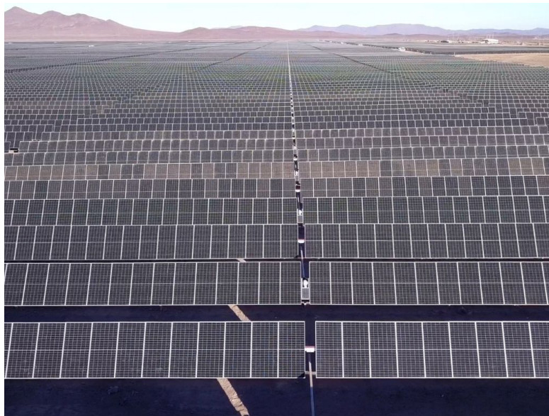
Acciona Energía instalará una batería de 1 GWh en el desierto de Atacama para reforzar la gestión de la energía solar en Chile.
