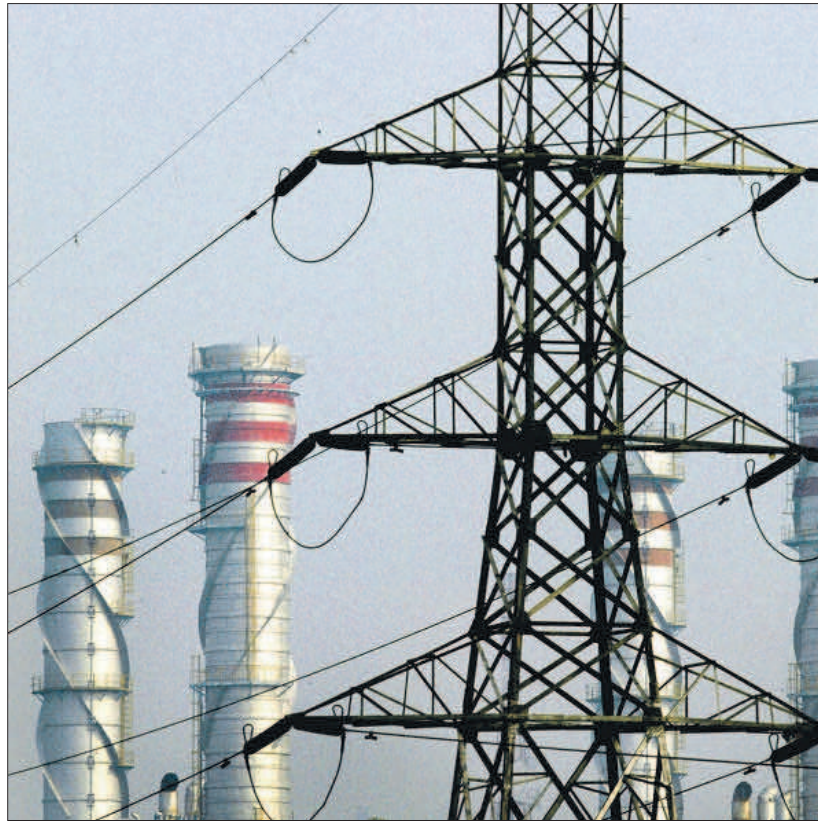
Un tendido eléctrico en una zona industrial. BLOOMBERG
