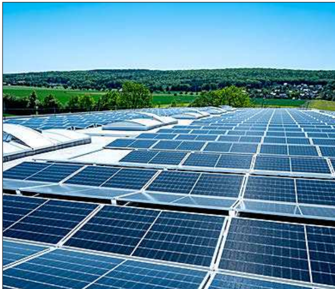
Instalación de energía fotovoltaica. EE
