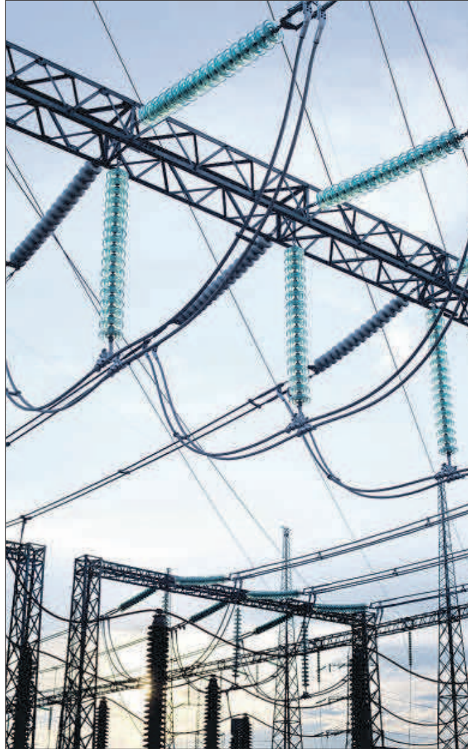
Una subestación eléctrica. ISTOCK
