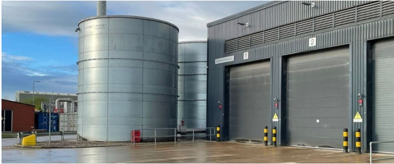
Planta de biogás | Foto de CIP.
