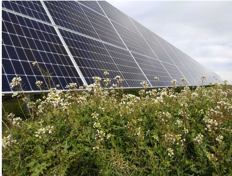
Instalaciones fotovoltaicas de Solaria.
