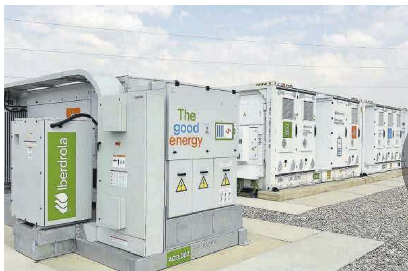
Parque de baterías Revilla de Iberdrola.
