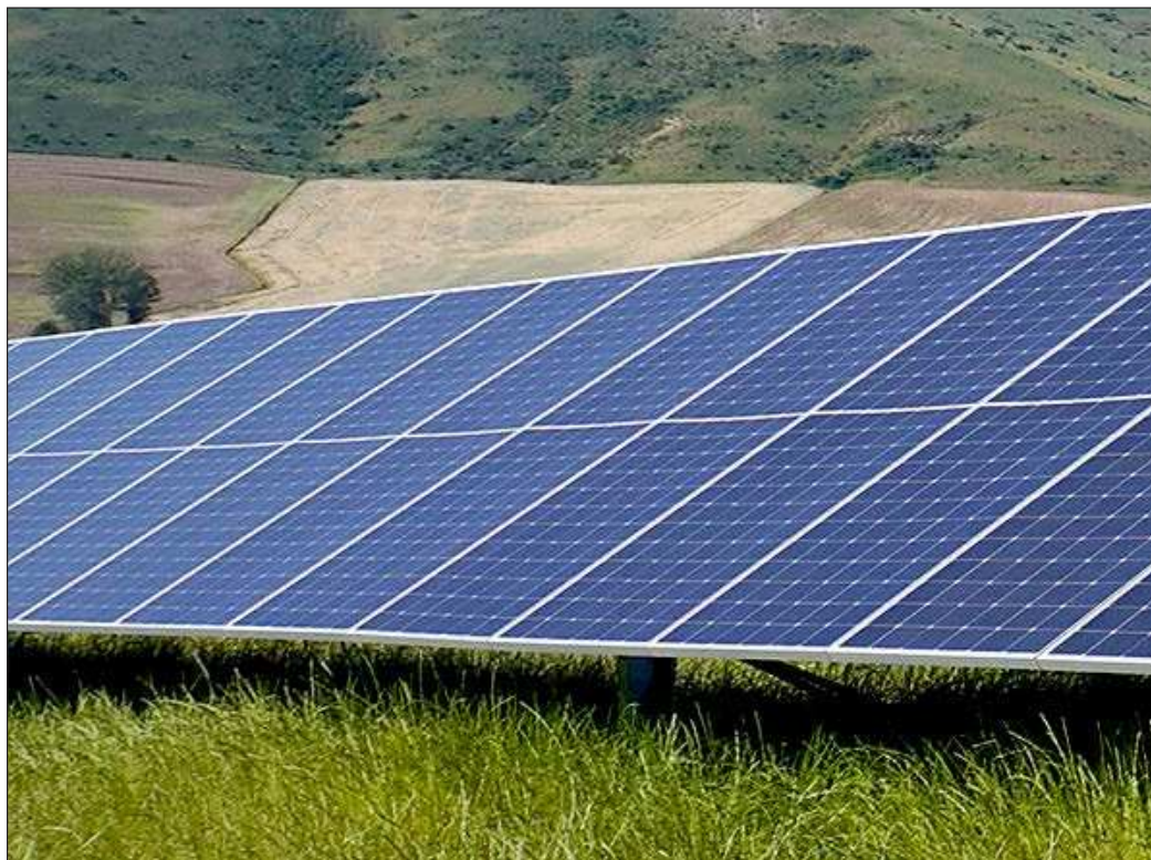
Planta fotovoltaica construida por Grupo Enhol. EE
