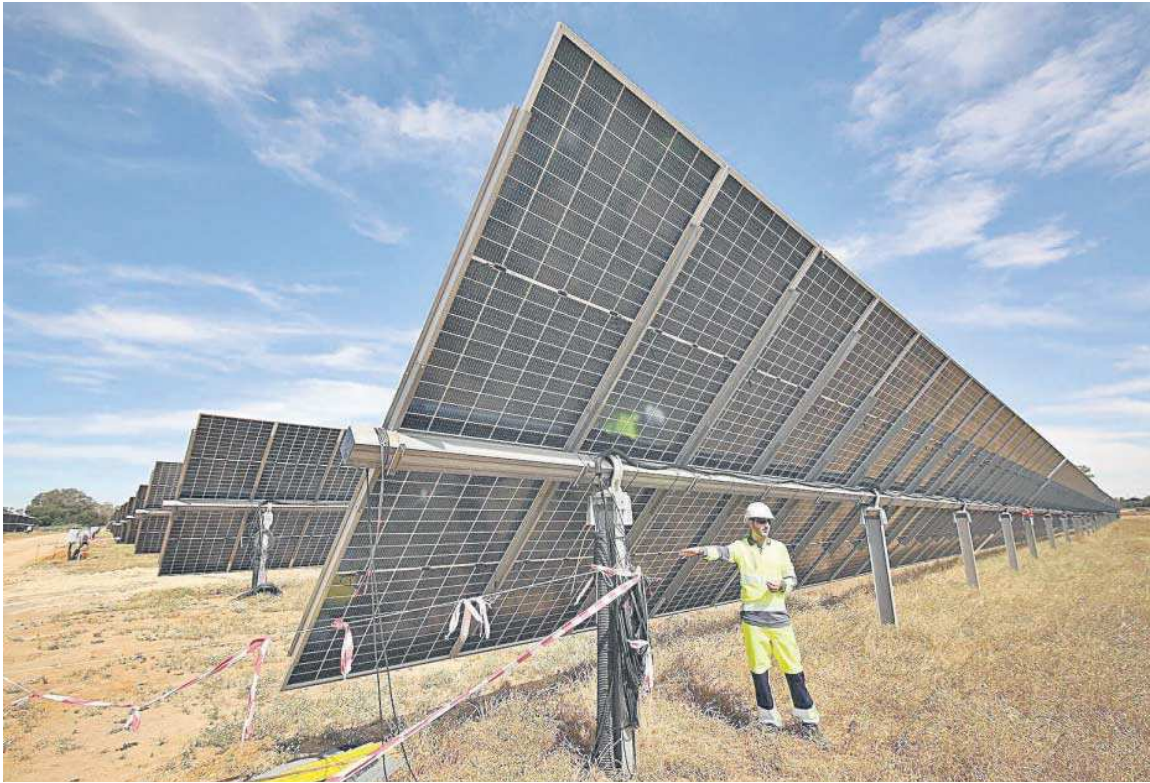
Planta fotovoltaica en una finca de la provincia de Huelva.
