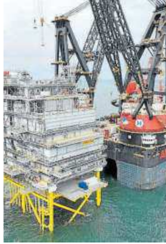
El módulo, instalado. Foto: Iberdrola
