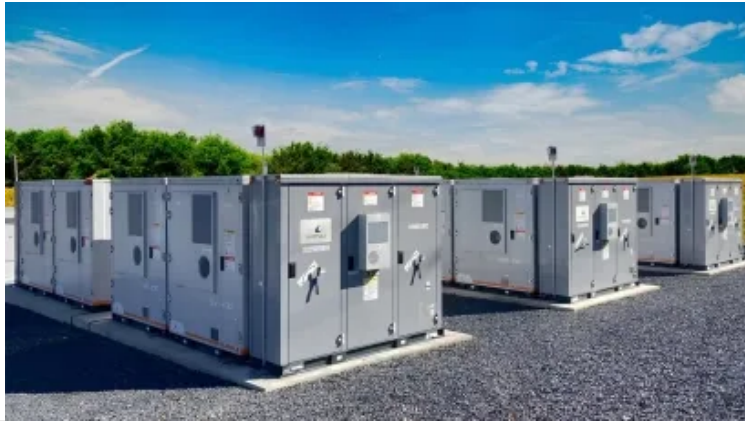
Baterías para almacenamiento de electricidad a gran escala. Fuente foto: Ministerio para la Transición Ecológica y el Reto Demográfico
