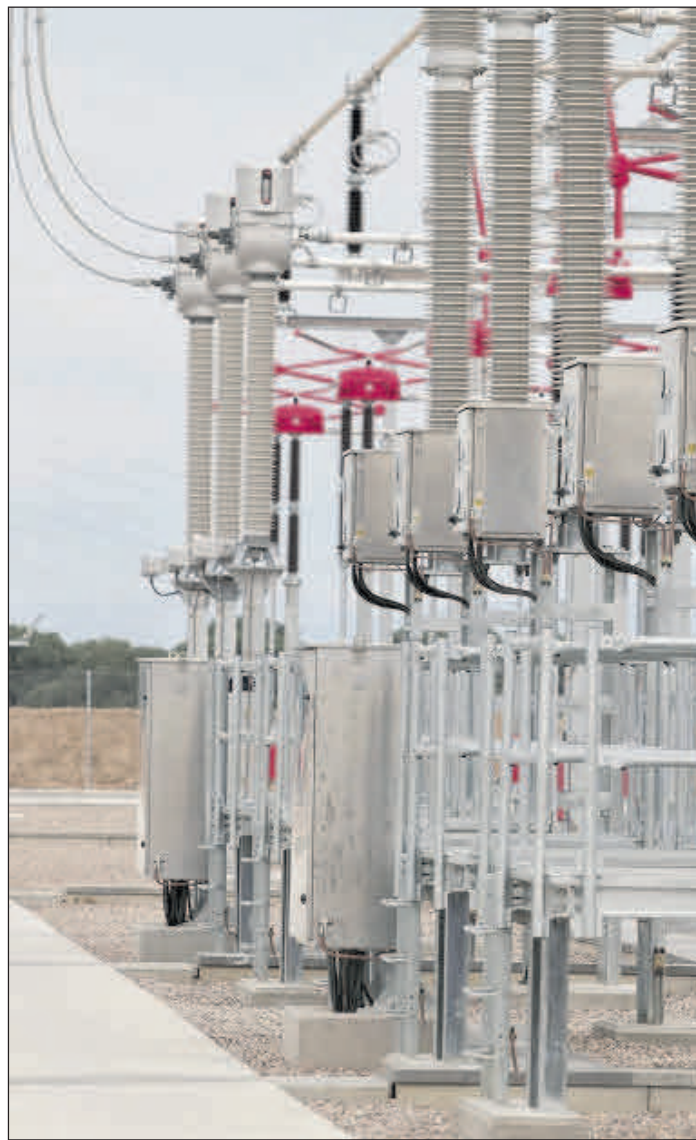
Subestación Calera y Chozas, inaugurada recientemente en Toledo. EP
