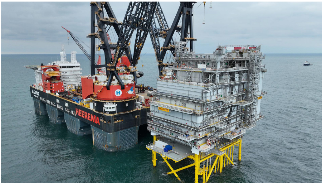
Iberdrola instala la estación convertidora de su 'megaparque' eólico marino 'East Anglia 3'.
