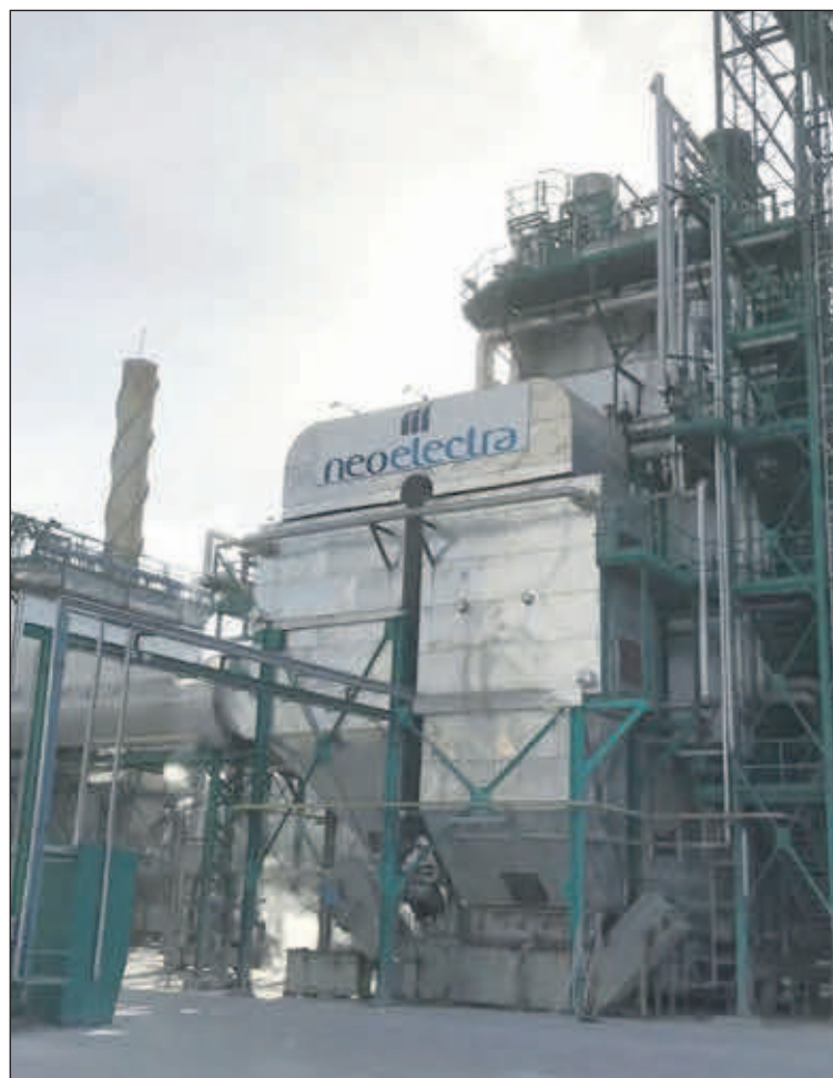
Instalación de Neoelectra. EE
