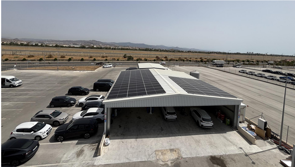
Aeropuerto de Málaga Costa del Sol.- Paneles solares.
