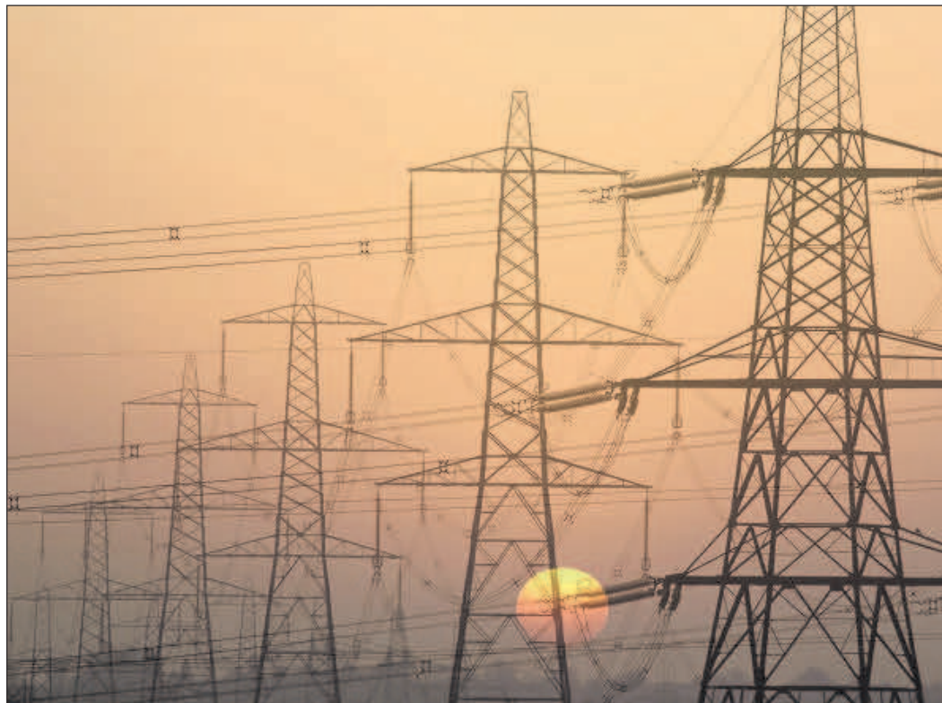
Un tendido eléctrico. JON BOWER
