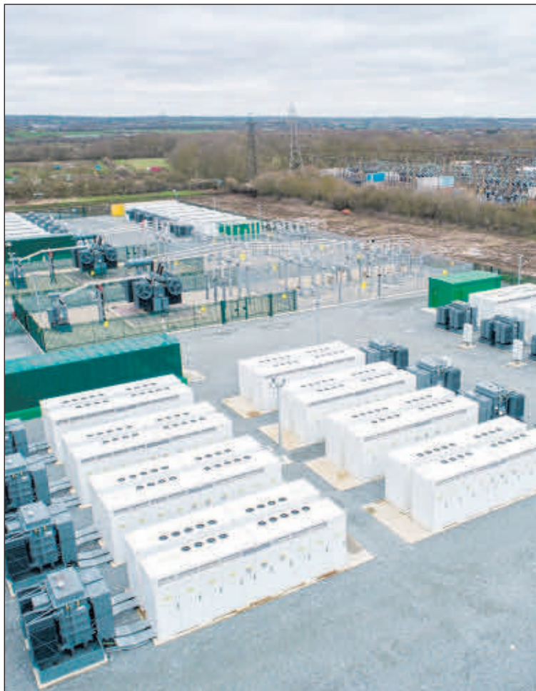
Instalaciones de baterías. EE
