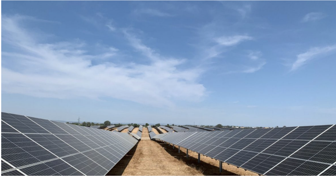
Planta fotovoltaica de Amarenco en Carmona, Sevilla.
