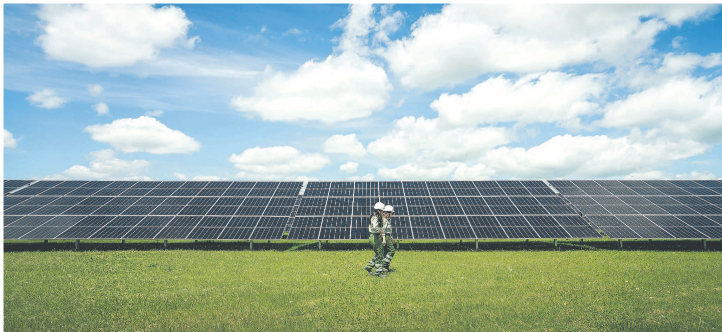
Planta fotovoltaica de Iberdrola en Castilla y León.
