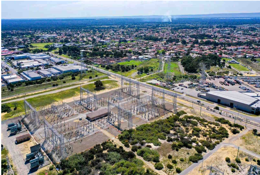
Vista aérea de la Western Power North Terminal en Malaga, Australia Occidental.
