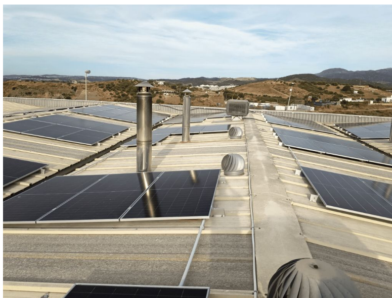
Minuscenter y Quantica inauguran una planta de autoconsumo de 67,8 kWp en Málaga.
