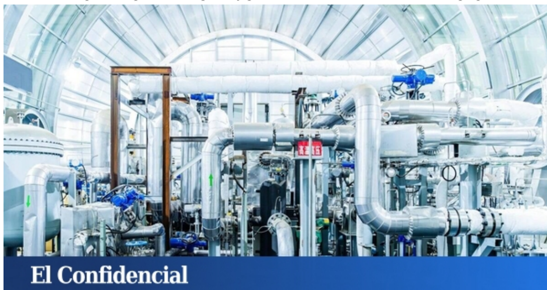
Foto: Un dispositivo experimental de conversión de calor de dióxido de carbono supercrítico. (Instituto de Energía Nuclear de China)
