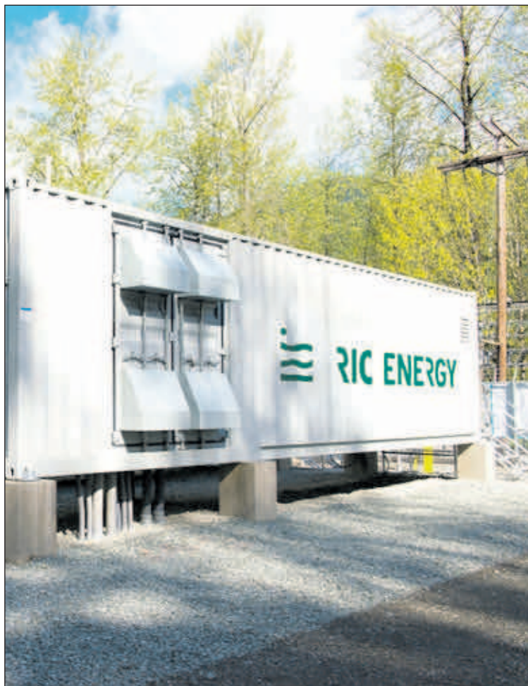
Sistema de almacenamiento a través de baterías (BESS) de Ric Energy. EE
