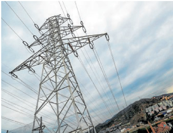
Una torre de tendido eléctrico // ABC
