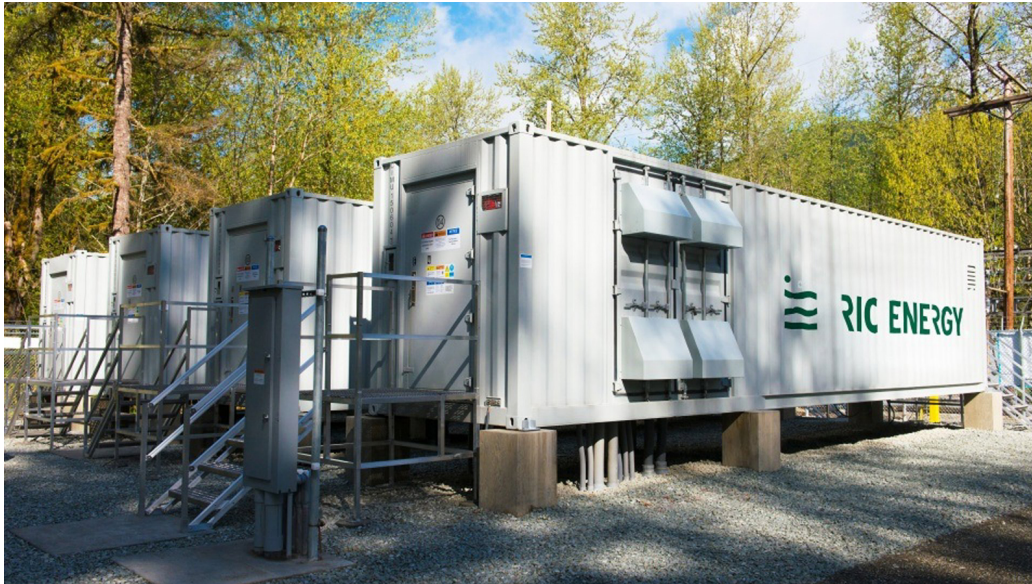
Sistema de almacenamiento energético.
