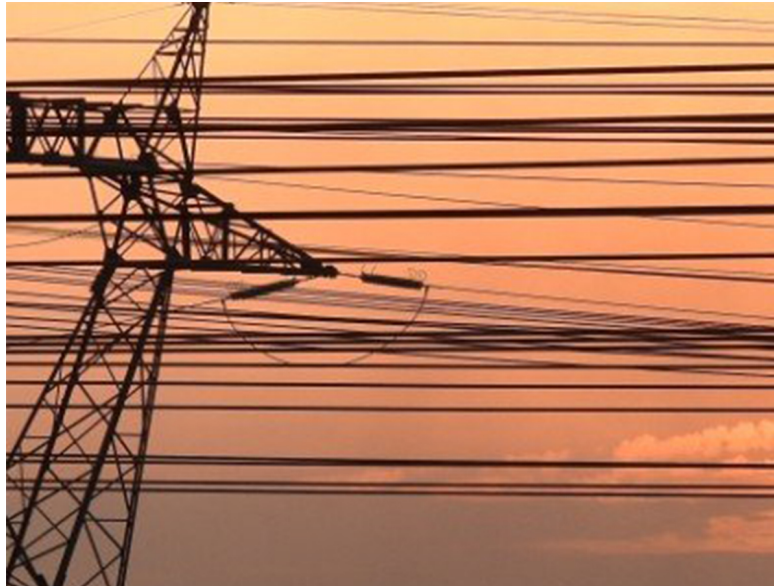
Tendido eléctrico en Francia.
