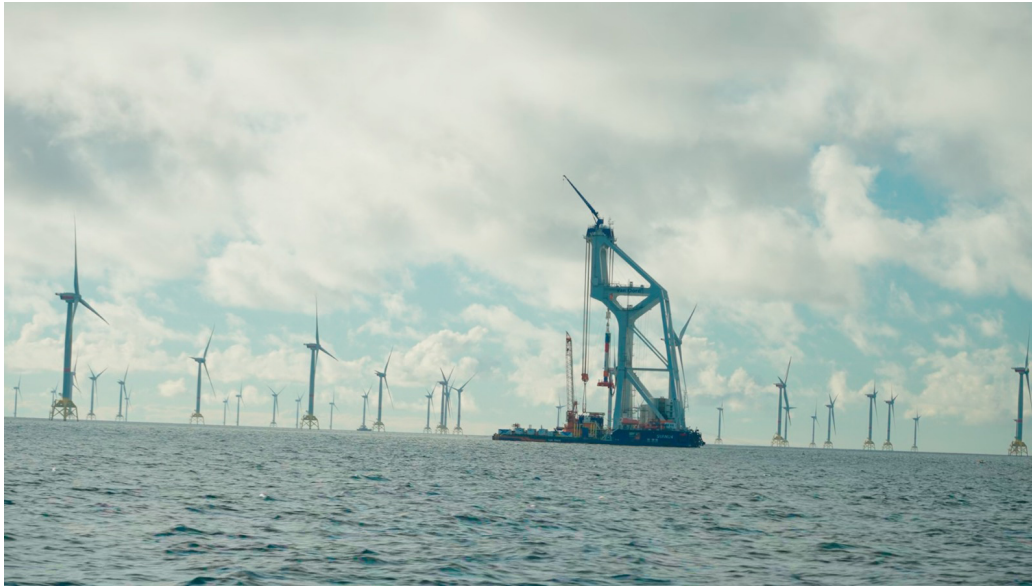
El parque eólico marino Windanker de Iberdrola.
