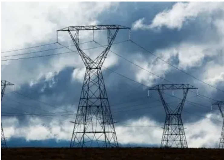
Europa pisa el acelerador para modernizar unas redes eléctricas al límite de su capacidad
