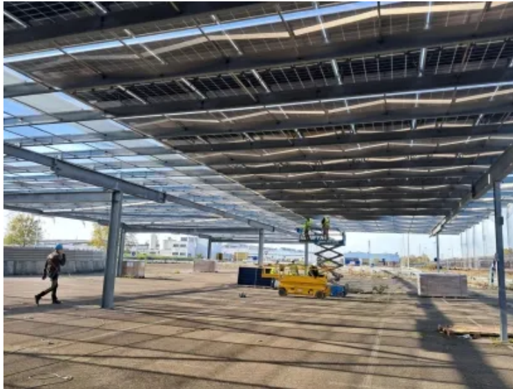
Sistema de 36 MW FV respaldados por un BESS de 25 MWh en Mulhouse.
