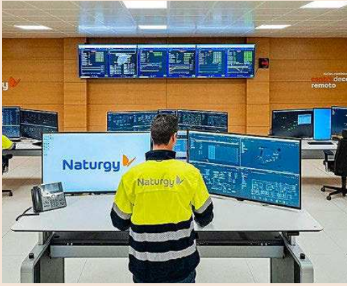
Centro de Control Remoto de Naturgy en Sagunto.
