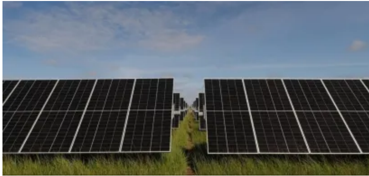
Parque solar fotovoltaico. Fuente foto: Ministerio de Minas y Energía de Colombia
