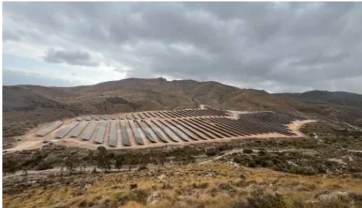
Instalación solar fotovoltaica ejecutada por la andaluza ISE Energía (Grupo Gransolar) en Almería, para su cliente Cajamar
