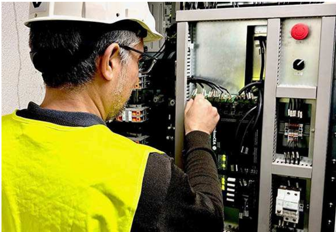
Trabajador mira un cuadro eléctrico. EP
