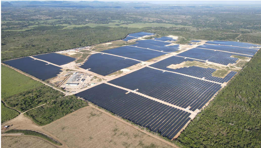
Planta fotovoltaica de Cotoperí Solar.
