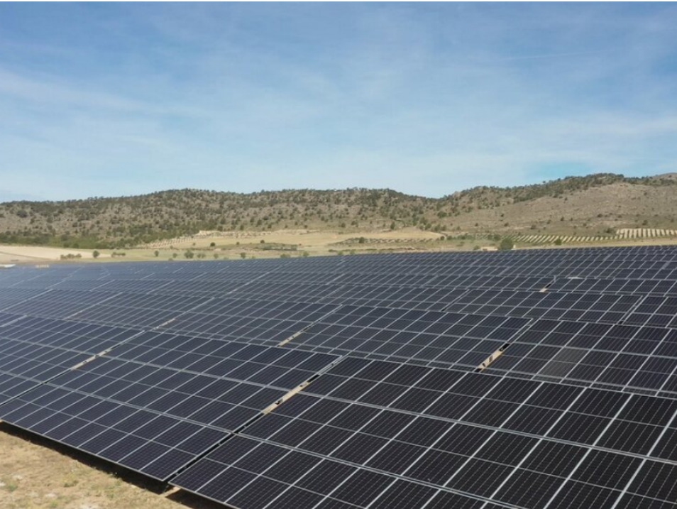
Planta fotovoltaica de Peñarubia (Yecla) . Foto: Iberdrola
