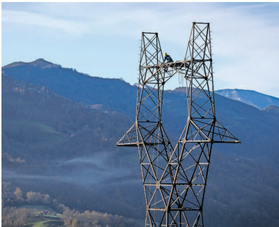
Línea de alta tensión Lada-Velilla en Laviana (Asturias), de REE. EP
