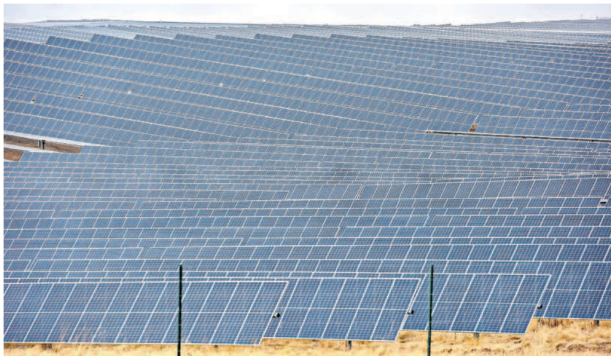
Paneles solares en una planta fotovoltaica. GETTY
