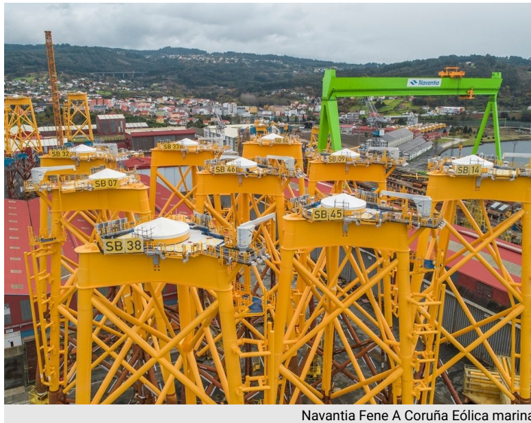
Navantia Fene A Coruña Eólica marina
