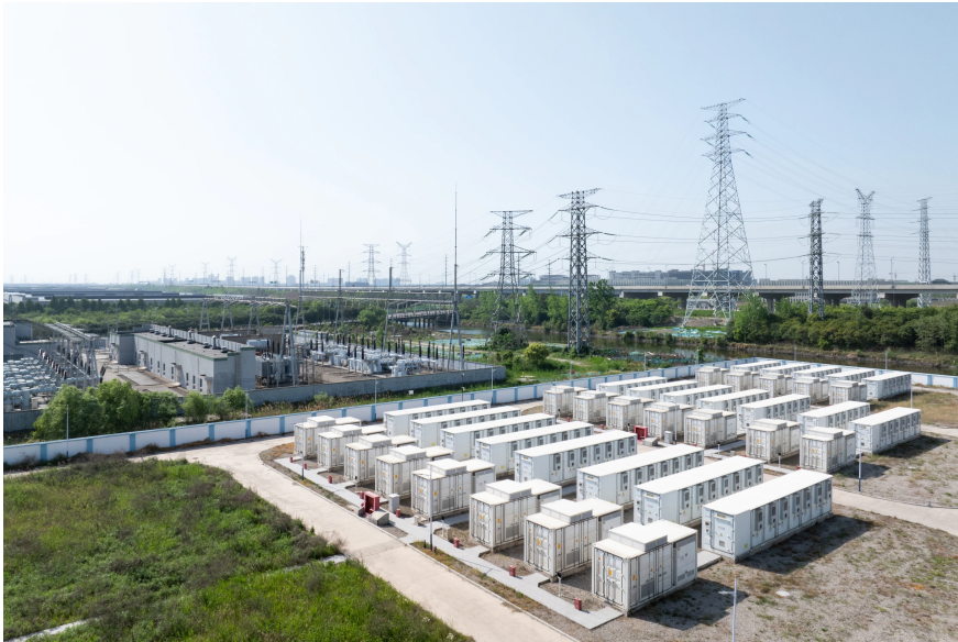
El mercado mundial de almacenamiento de energía supera el hito de 100 GW de instalaciones anuales en 2025
