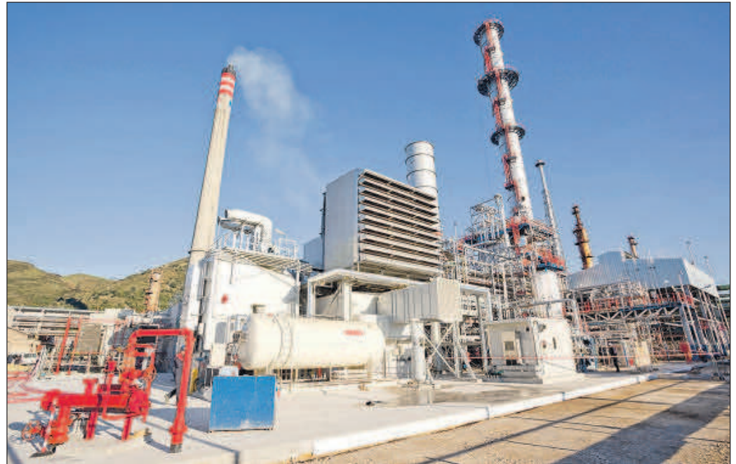
Una planta de cogeneración. LUIS DÍAZ RÍO
