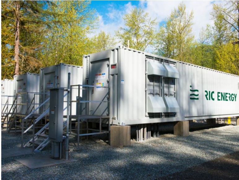
RIC Energy eleva su cartera de almacenamiento BESS en Italia hasta los 942 MW.
