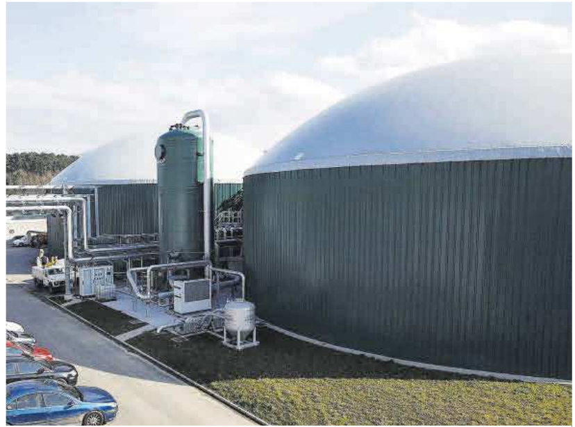
Digestores de la planta de biometano de Biogastur en Navia.
