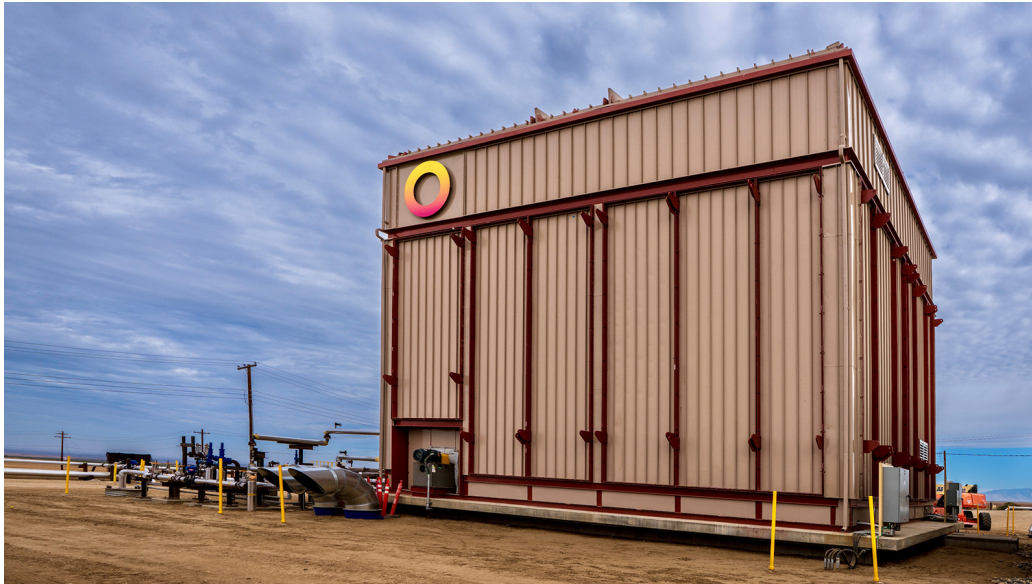
Heineken, Rondo y EDP impulsan en Lisboa el mayor proyecto de almacenamiento térmico en la Península Ibérica.
