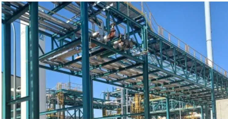
Instalaciones de Ciuden donde se ubicará la planta piloto de producción de metanol
