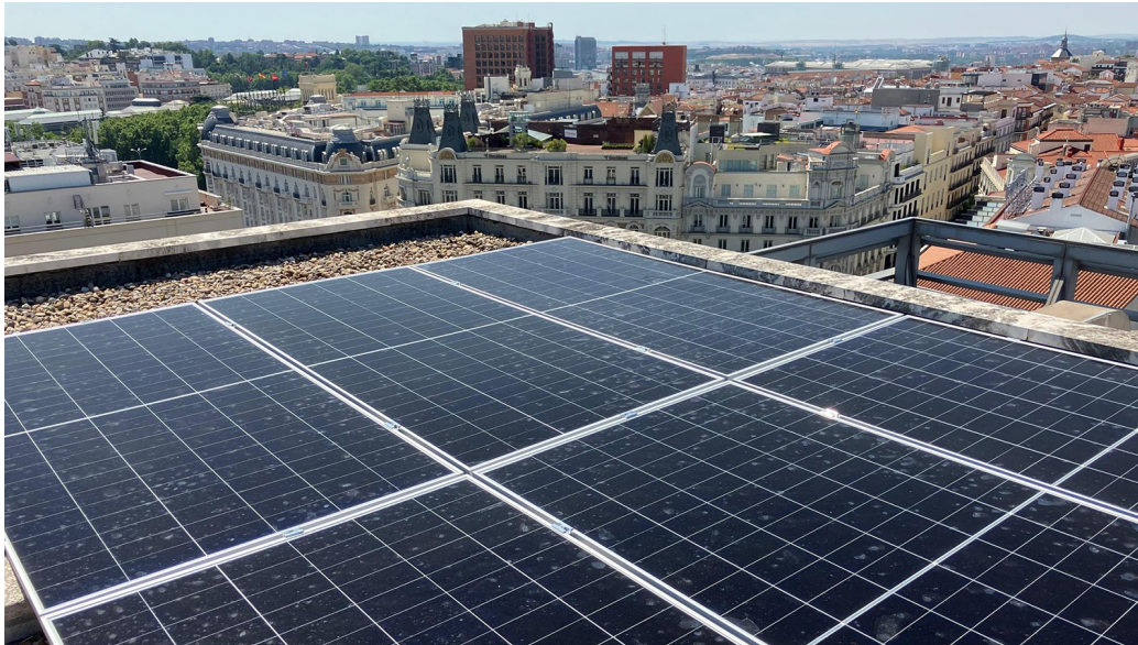
Instalación fotovoltaica de Iberdrola en el Congreso de los Diputados.
