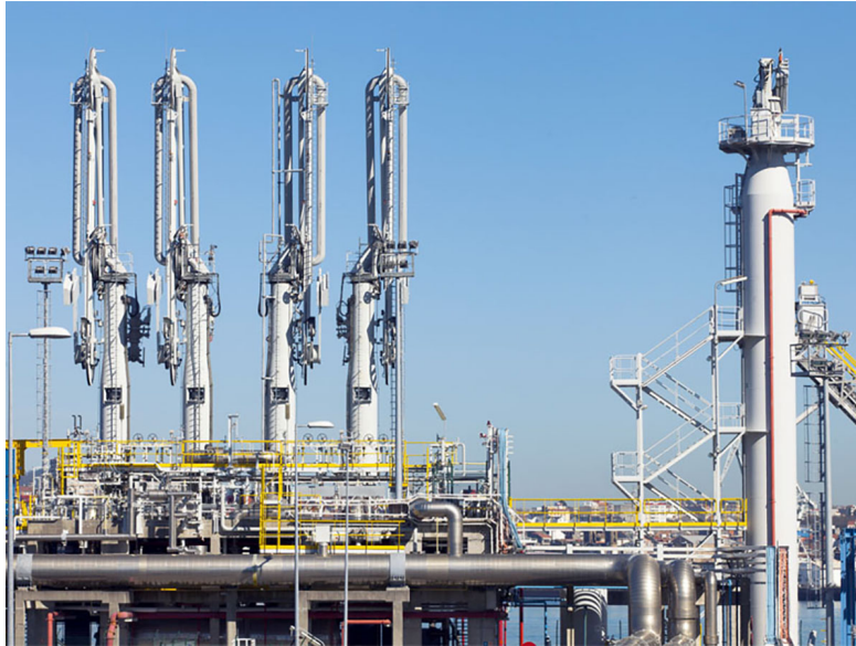
Las instalaciones de Reganosa en su terminal de GNL. FOTO: Reganosa
