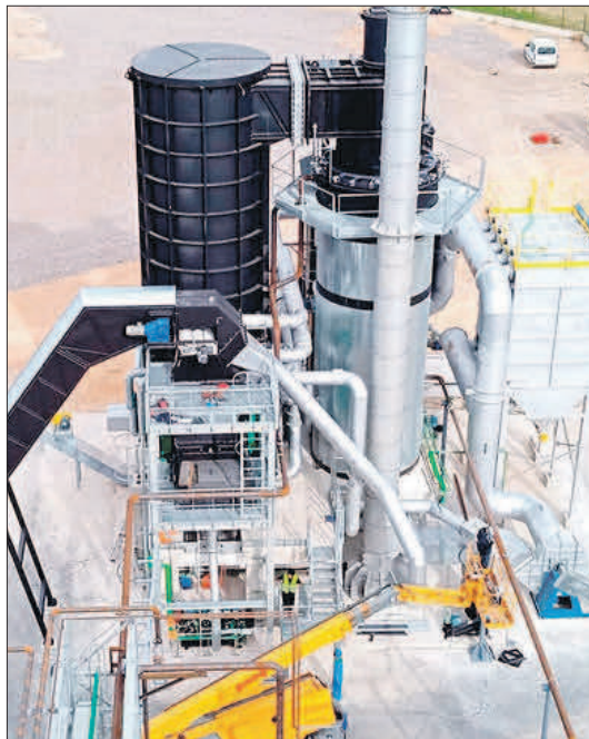
Una planta equipada con calderas de V Power Plants. EE
