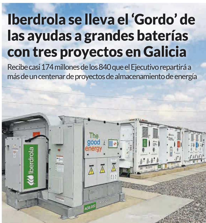
Instalación de baterías gestionada por Iberdrola. | ECG
