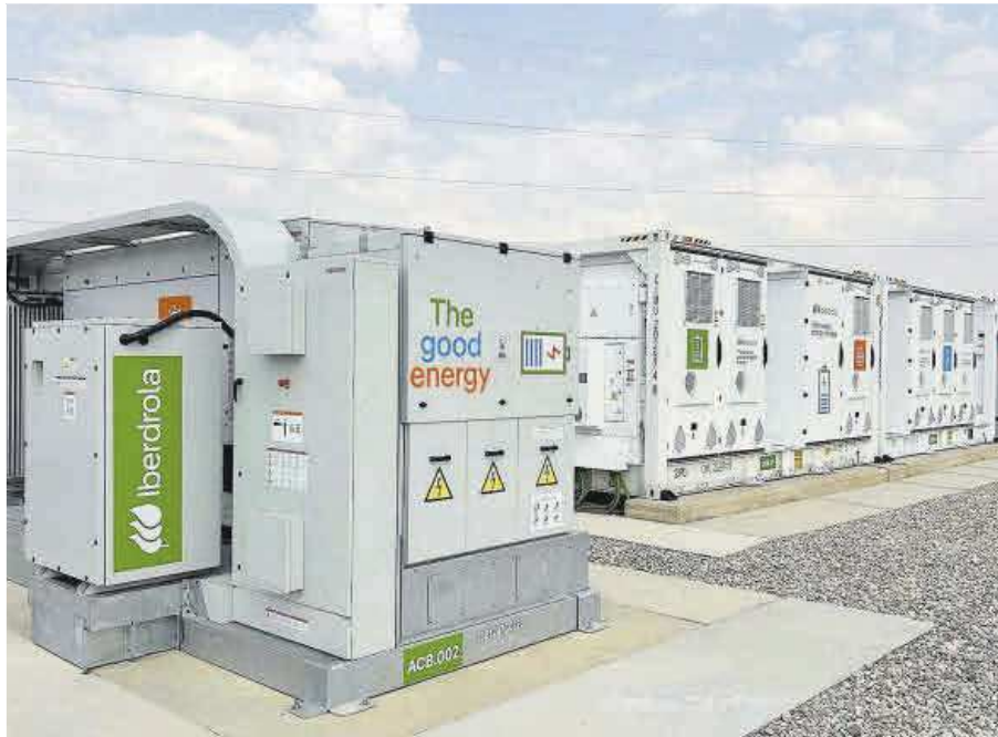
Proyecto de baterías de la compañía eléctrica Iberdrola.
