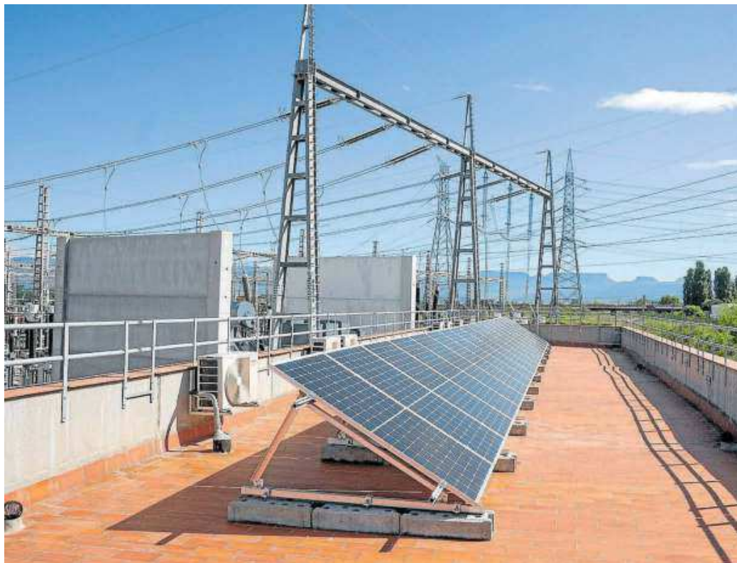
Vista general de una subestación eléctrica. Foto: E.P.
