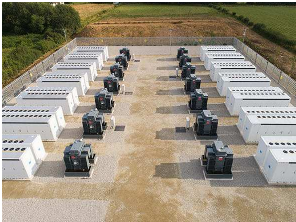
Sistema de almacenamiento con baterías desarrollado por FRV en Reino Unido. FRV
