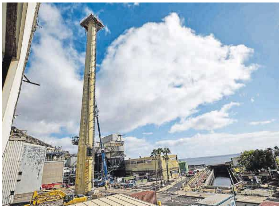
Vistas de la central eléctrica de Las Caletillas.
