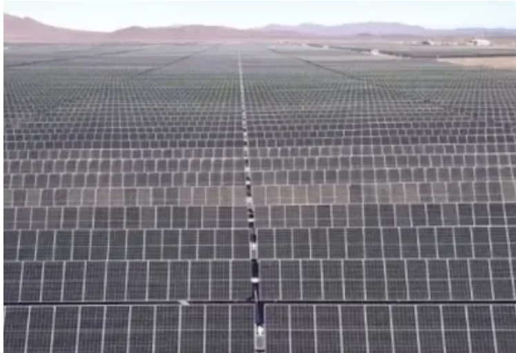
Acciona dotará al complejo solar de Malgarida, en Chile, de 1 GWh de almacenamiento
