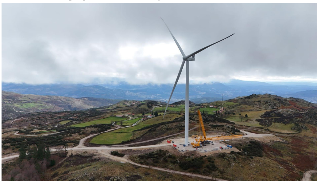
Primer aerogenerador del complejo hidroeléctrico de almacenamiento por bombeo del Tâmega, en el norte de Portugal.
