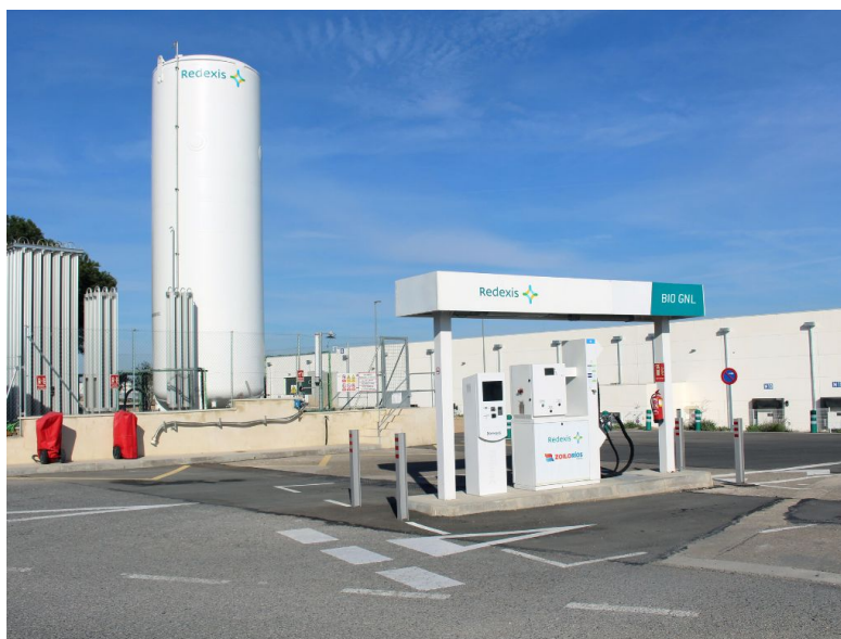
Redexis, Zoilo Ríos y Axpo activan la primera estación pública de bioGNL y biometano en España.
