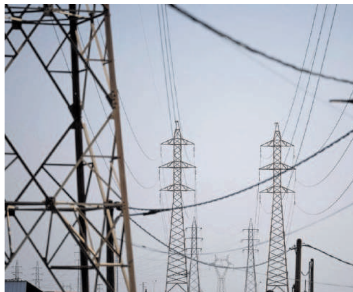
Líneas de distribución eléctrica en Sevilla. PACO PUENTES
