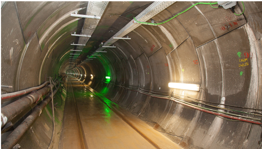
Túnel de a interconexión eléctrica España-Francia por los Pirineos orientales.
