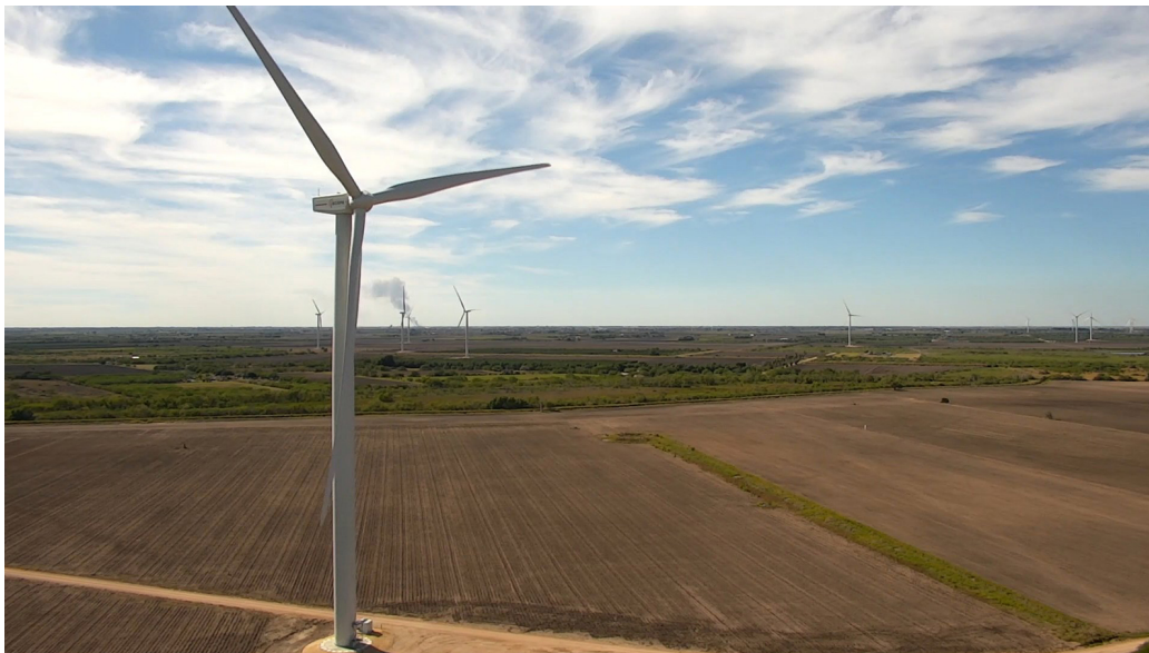
Parque eólico de Acciona Energía.
