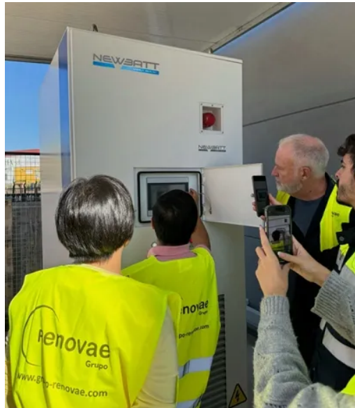
Newbatt Energy y Grupo Renovae instalan en España una de las primeras baterías con refrigeración líquida
