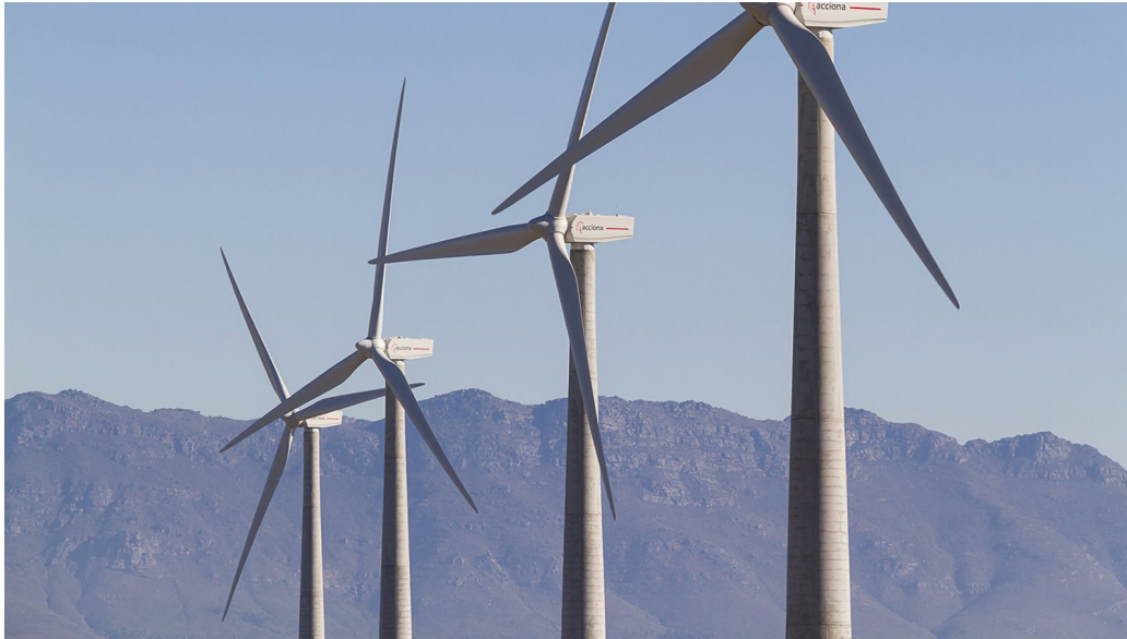
Parque eólico Gouda de Acciona Energía.
